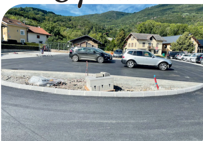
Livraison du parking pour la rentrée scolaire et début des travaux sur la route d'Esery : création d'une vingtaine de places de parking et route départementale élargie
